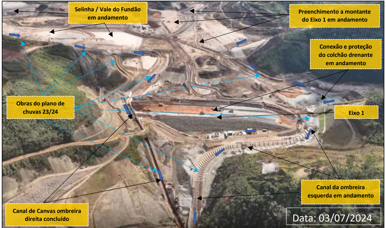
Foto 7: Vista da Barragem Eixo 1 – Obras de Preenchimento e Canal da Ombreira Esquerda em Andamento
