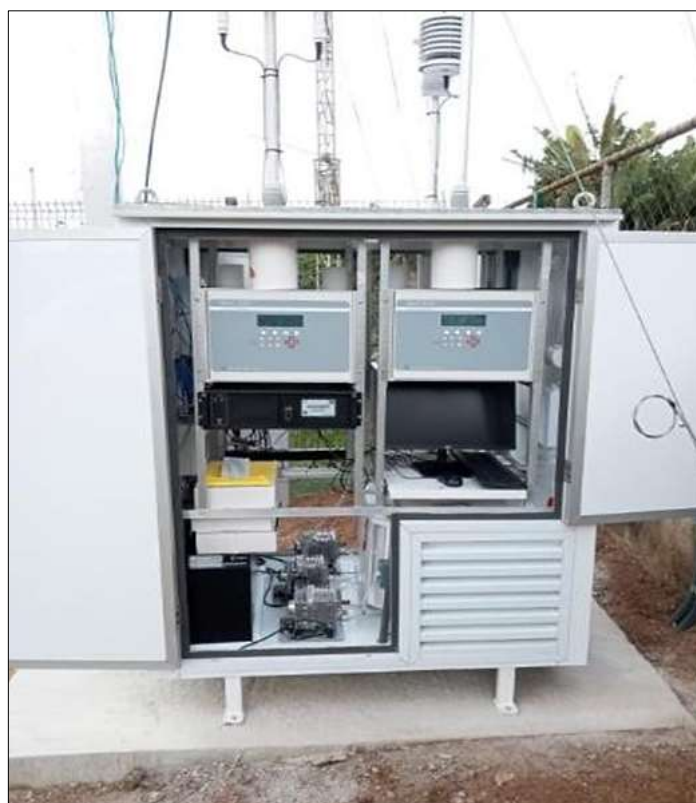
Figura 140: Detalhes dos Equipamentos da Estação de Monitoramento em Santa Rita Durão
