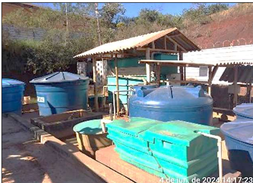
Figura 24: Caixa SAO em Destaque – Oficina de Manutenção da Contratada MRF
