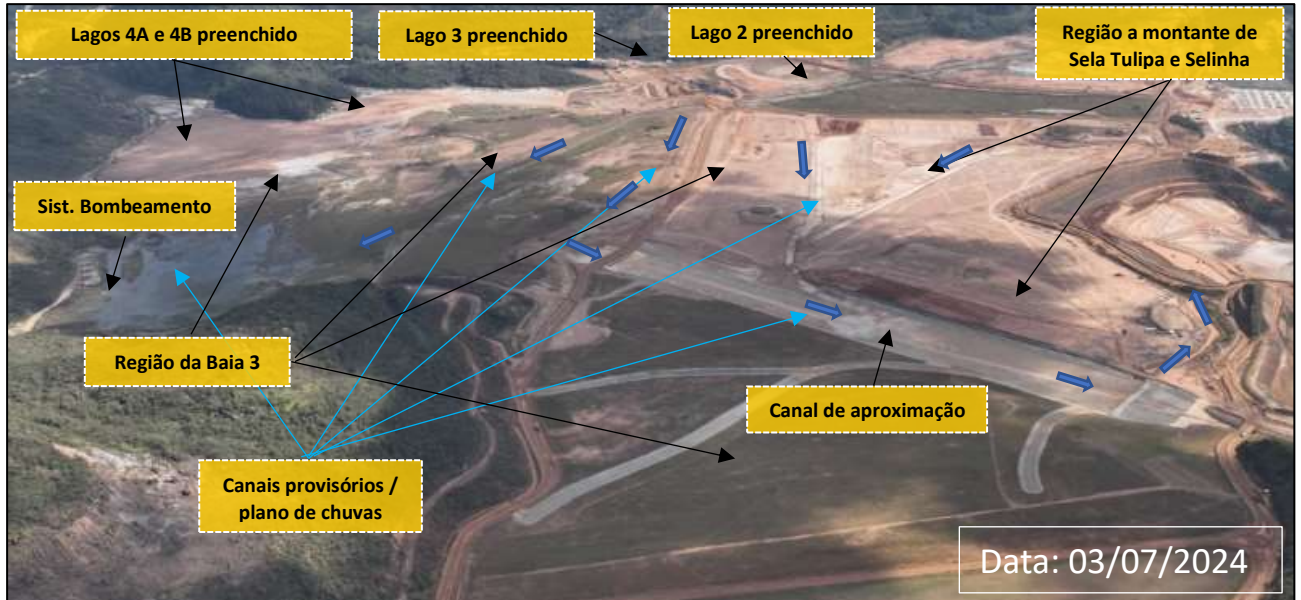
Foto 11: Região da Baía 3 e dos Lagos 2, 3, 4A e 4B (Obras em Andamento)
