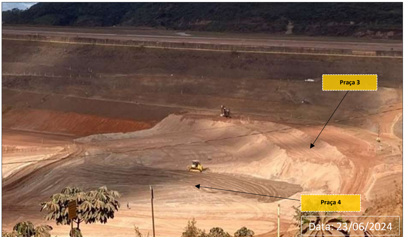
Foto 15: Vista da Execução do Reforço de Sela Tulipa – Praças 3 e 4 (Obras em Andamento)
