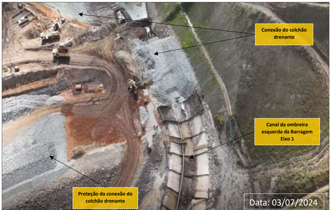
Foto 21: Conexão do Colchão Drenante e Canal da Ombreira Esquerda (Obras em Andamento)
