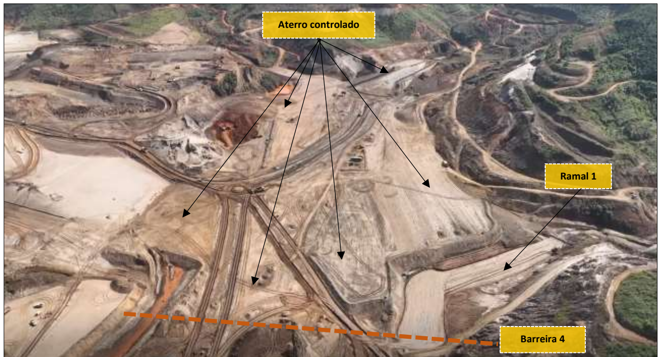
Foto 25: Conexão do Colchão Drenante e Canal da Ombreira Esquerda (Obras em Andamento)
